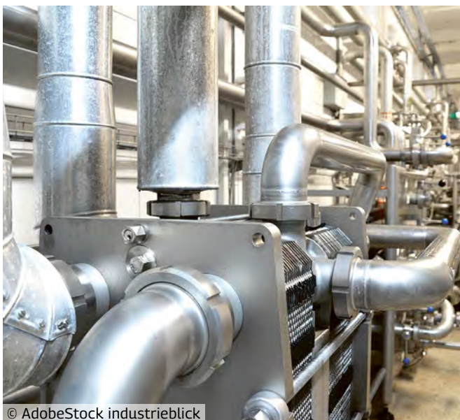
© AdobeStock industrieblick In den Kellern braucht es zahlreiche Rohrverbindungen und Geräte.
