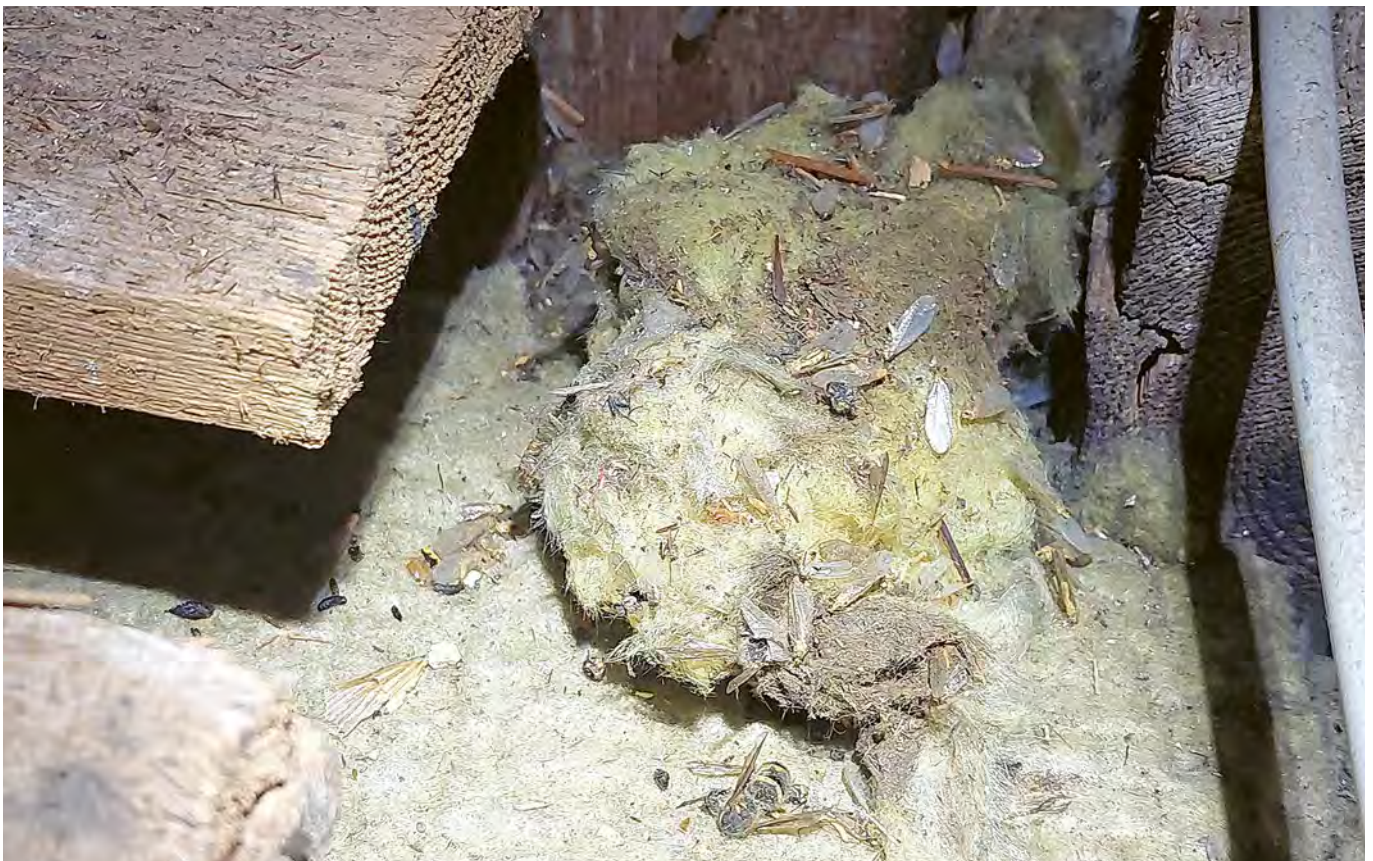
Fraß- und Kots Spuren von Fledermäusen auf dem Dachboden
